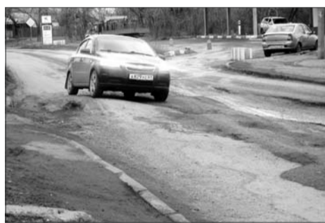
На состояние дороги в районе Северного переезда жители жалуются уже не первый год.
