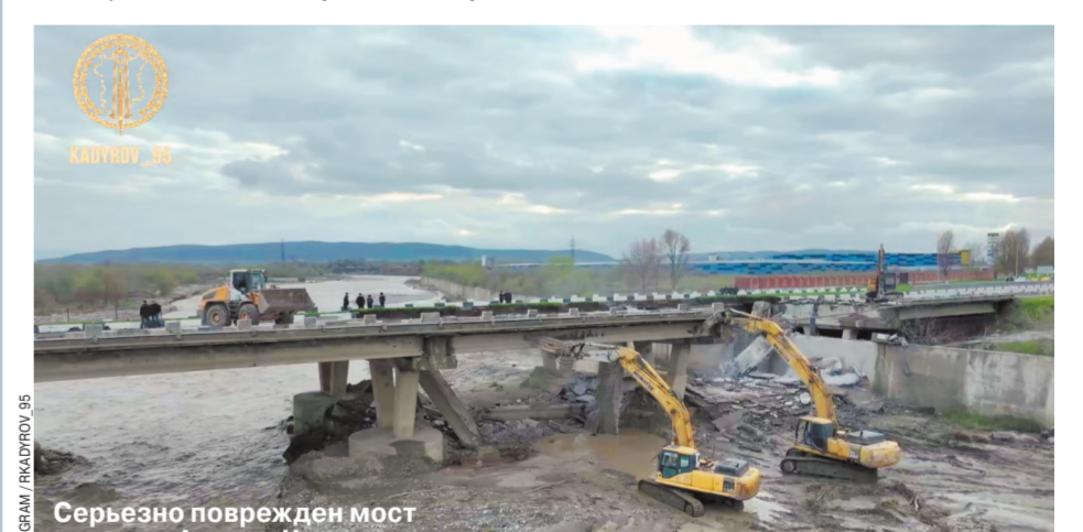
Серьезно поврежден мост в городе Аргун в Чечне.
